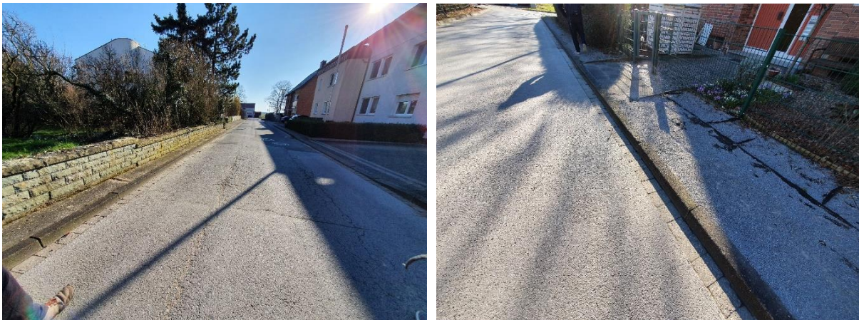
Abbildung 2-33: Mangelnde Barrierefreiheit auf Geh- und Radweg Bad Lippspringe (Quelle: Eigene Aufnahme 2022)
