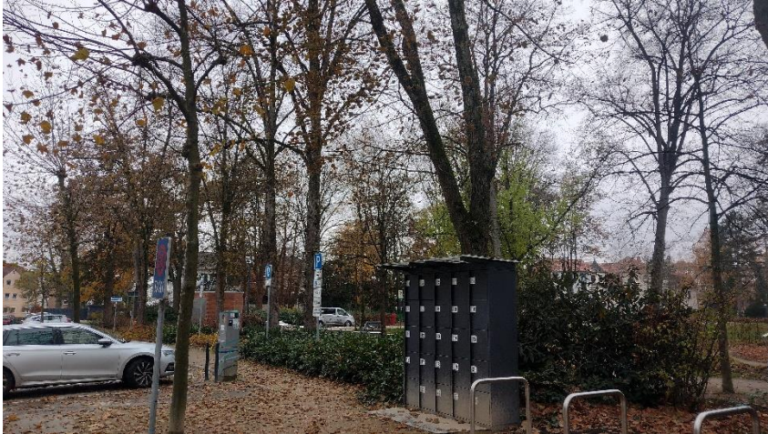
Abbildung 2-24: Ladeschränke an der Arminiusstraße (Quelle: Stadt Bad Lippspringe)
