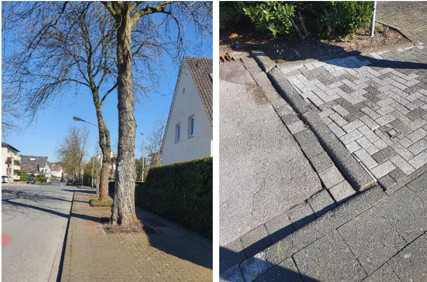
Abbildung 2-32: Mangelnde Barrierefreiheit auf Geh- und Radweg Bad Lippspringe (Quelle: Eigene Aufnahme 2022)
